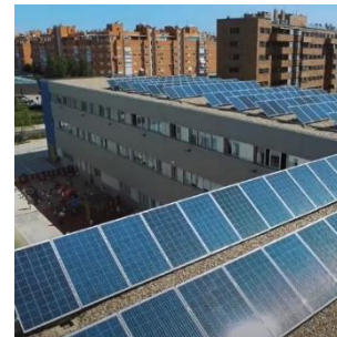
Figura 118. Paneles solares en la azotea de un colegio público. Fuente: www.powen.es
