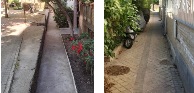
Figura 29. Aceras estrechas y poco accesibles: pavimentos discontinuos y/o con desniveles. Fuente: Elaboración propia
