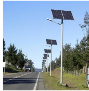
Figura 122. Farola solar en Navarra. Fuente: www.diariodenavarra.es
